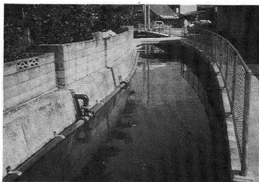
写真3 水路添架管及び取水口
