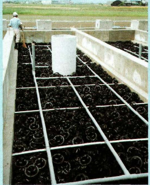
接触ろ過槽内プラスチックろ材
