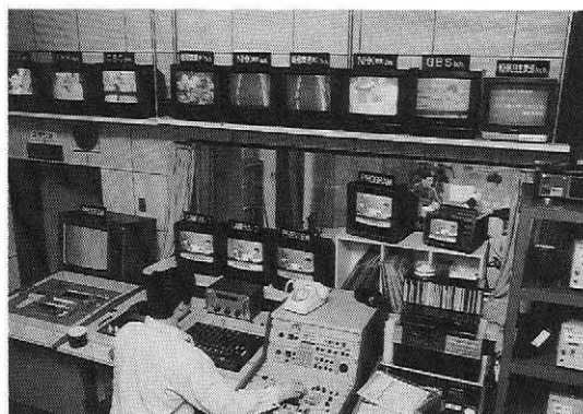
写真-3 放送局調整室
