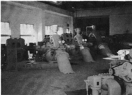
写真—6 東浦揚水機場ポンプ室
