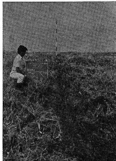
写真-2 堤体からの漏水
