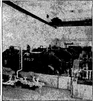
排水用横軸軸流ポンプ (千葉県殿 新堀川排水機場)
