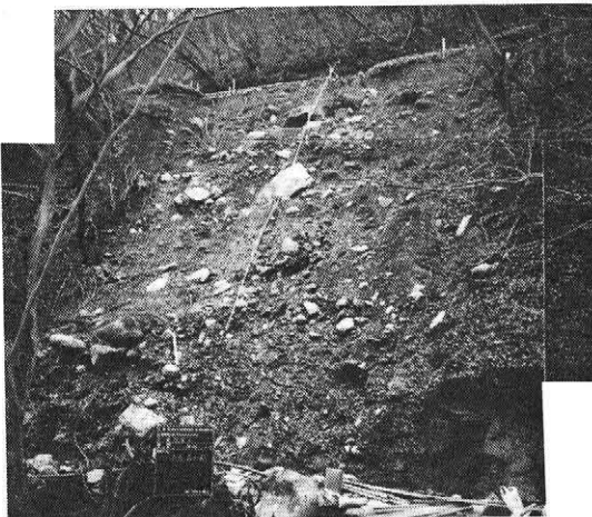
法面崩壊状況
