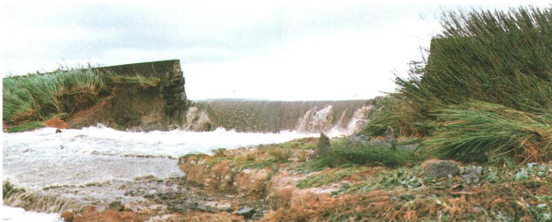
③ 欠壊し海水が農地に流入している状況
