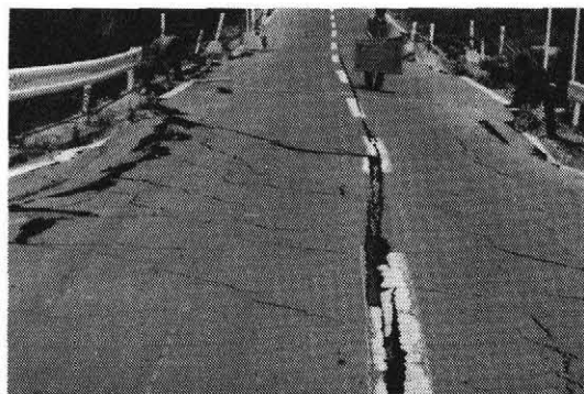
写真三 農道の陥没・亀裂・移動状況（大潟村）
