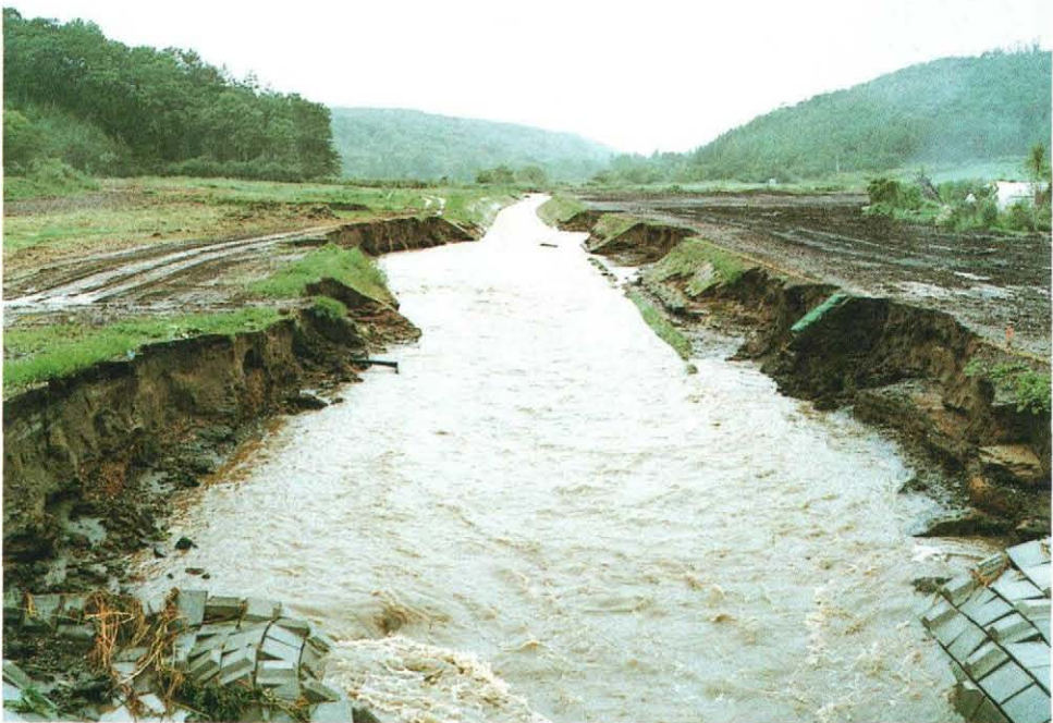
① 被災状況
