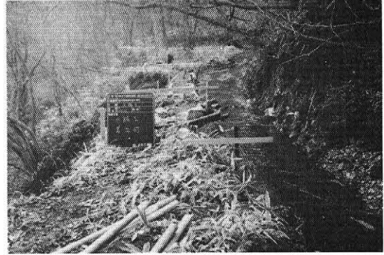
水路崩壊状況
