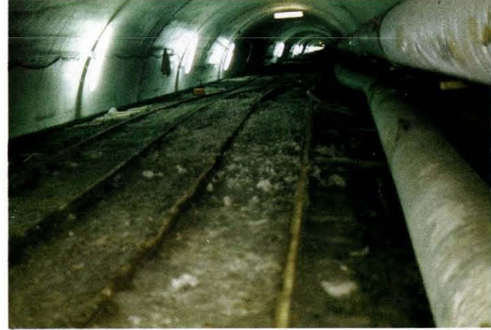
写真-4 盤膨れ箇所 (1,675m附近)
