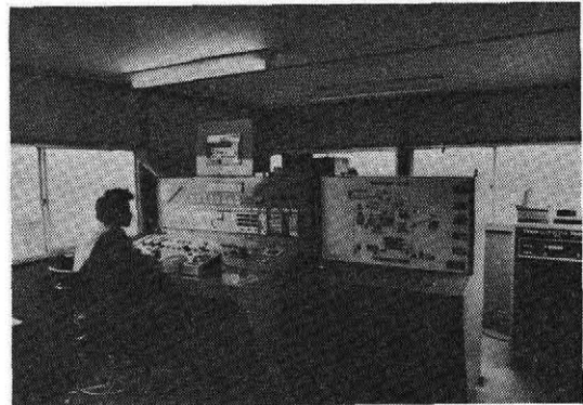
写真-6 中央制御盤
