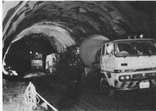
写真-2 吹付機械設備
