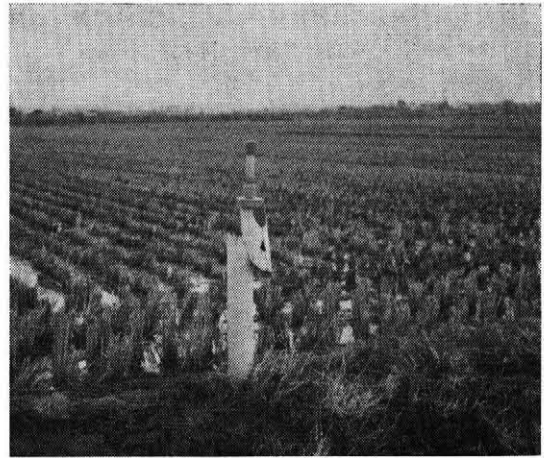
写真一 水閘の破損 (地上部本体の破損)
