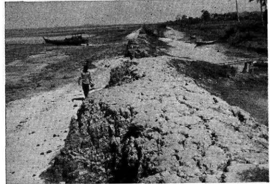
写真一5 海岸侵食を受けた Coastal Bund
