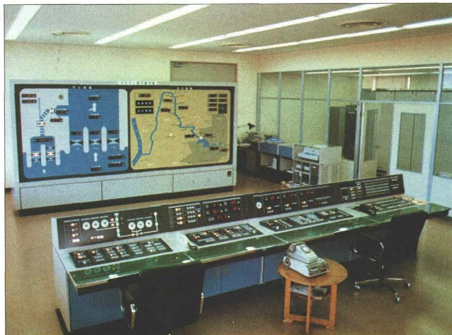
管理所ダム操作室における操作卓およびグラフィックパネル
