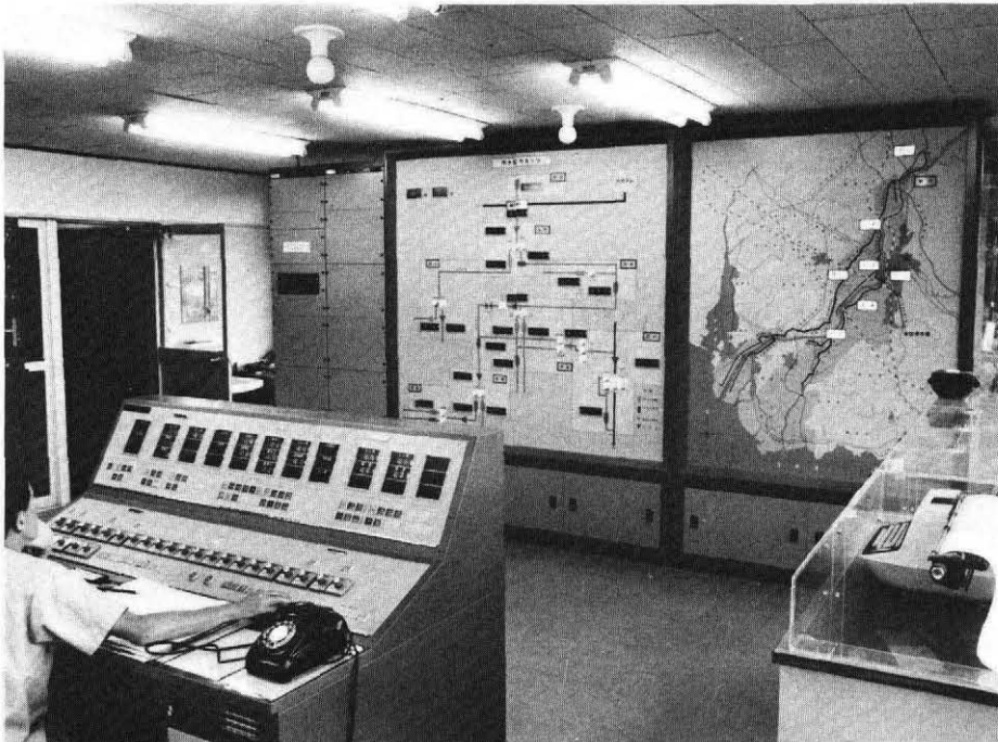
細川頭首工管理所の用水遠方監視制御装置 (幹線用水路主要分土工テレメータ・テレコン装置)
