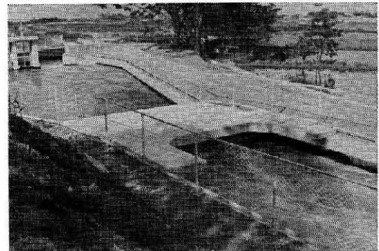
写真一 4 波返しを取付けた消波工の一事例 (上流側から見る)
