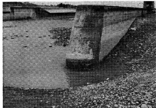
写真3-2 導流壁尖端の洗掘
