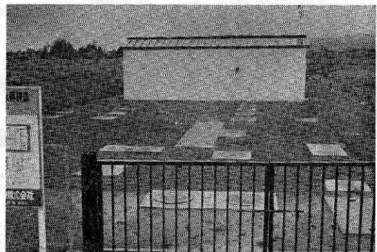
写真一八 供用開始した狩谷野目集落排水処理場（土壌式 450人槽）
