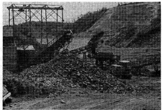
写真-3 フルイ分けプラント設備
