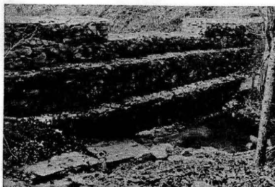
写真一4 フトン籠堰堤
