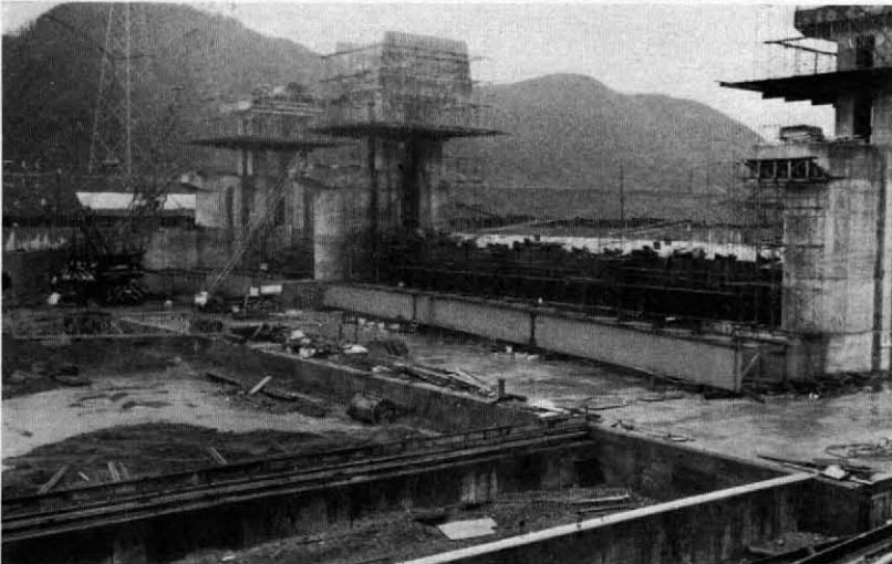
右岸側の土砂吐および洪水吐ゲート並びに管理橋の組立状況
