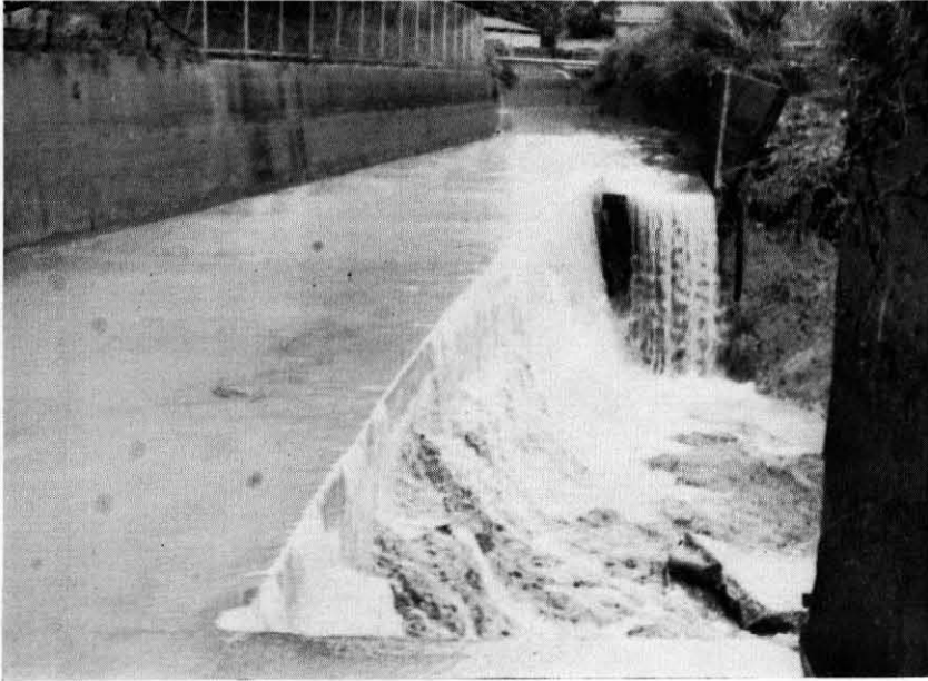
枝下幹線水路の決壊（豊田市栄町）（本文43頁参照）
