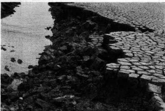
写真—4.3 小排水路の法面崩壊(40年頃)
