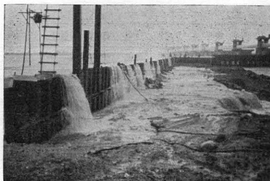
写真-4 融雪洪水が仮締切天端から越流しているところ
