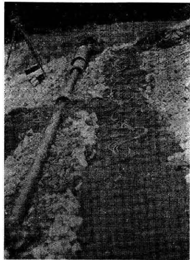
写真-4 動的相対変位計の設置
