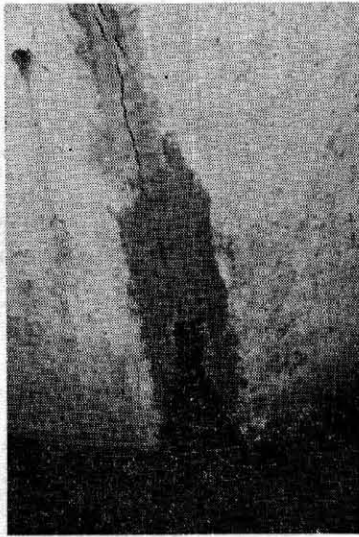
写真-2 レジンをコーティングした防食膜がコンクリートのクラックでひびが入り内部が腐食される
