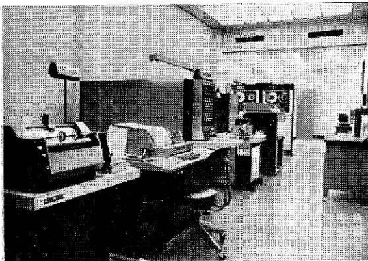
写真-5 制御装置室
