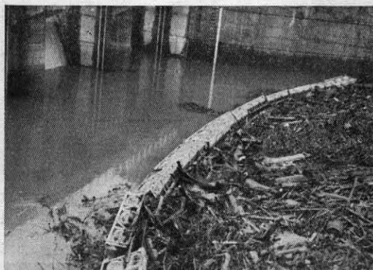
写真一 牧尾ダム フロートスクリーン付近のゴミ
