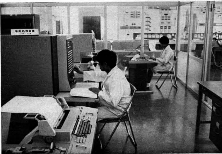
総合管理所 電算機室
