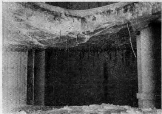
写真-4 取水塔内凍結状況 (大夕張ダム)
