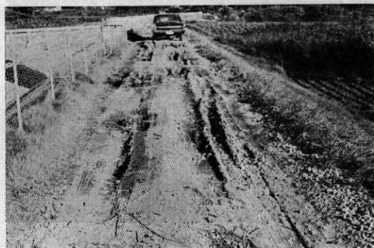
写真一七 痛んだ管理道路
