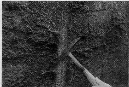
写真-19 10年経過の開水路側壁。木製型枠とスティールホームの差は感じとれない。
