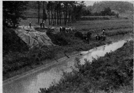
写真—16 うすいコンクリート水路の破損。背後地はわずか2～3mである。
