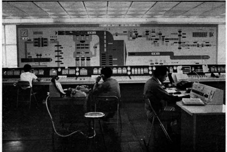
総合管理所 表示盤及び操作卓
