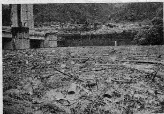
写真二 大野頭首工付近のゴミ。河の水面がゴミのため見えない状態である。
