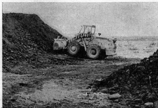
写真-1 廃材の堆積状況
