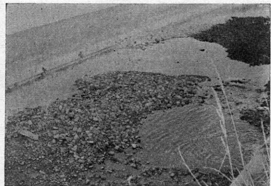
写真-5 インパートの部分的堆積状態
